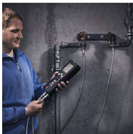
Zkouška provozuschopnosti bez napájecího zařízení
