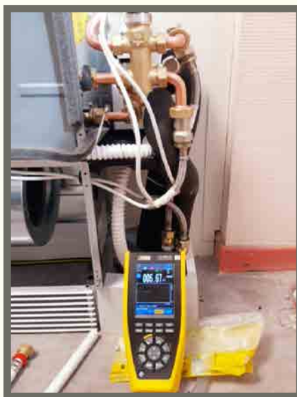
Měření na topných a klimatizačních systémech: proud, napětí, teplota
